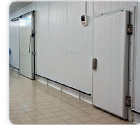
Cold Room Doors / Soğuk Oda Kapıları
